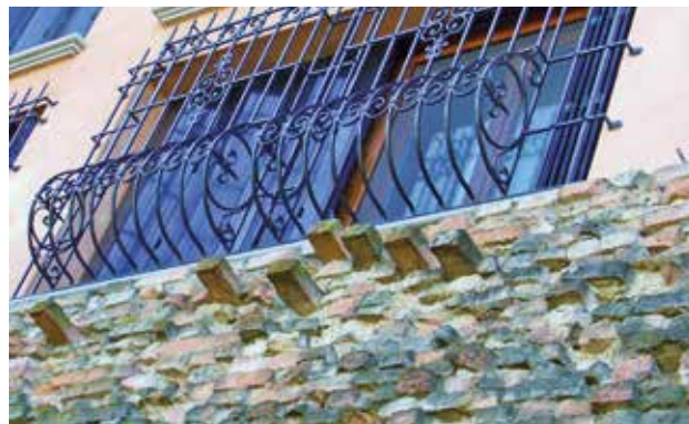
↳ Il crollo del rivestimento esterno.
